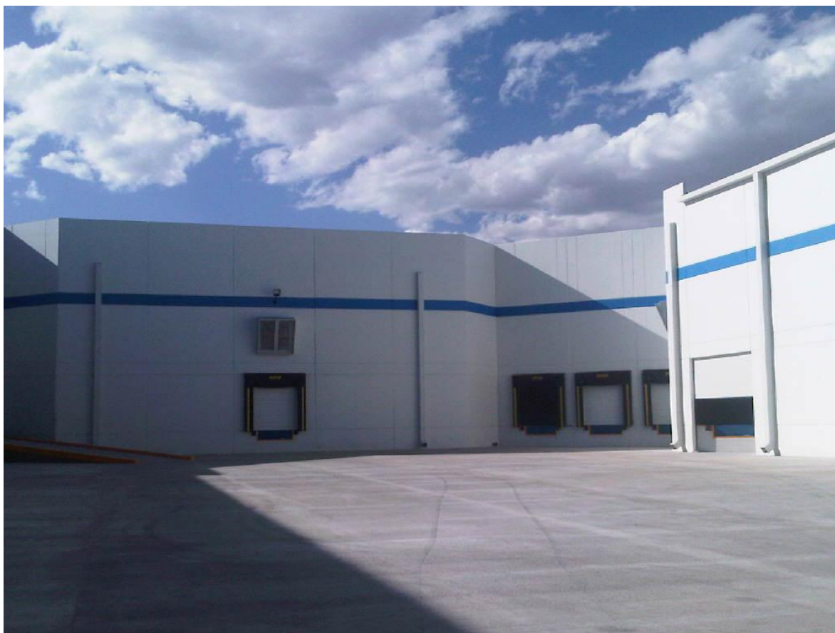
Figura 3.19. Canalones y bajadas pegadas a los muros.
