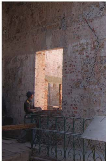
grieta en muro, Mina #143
