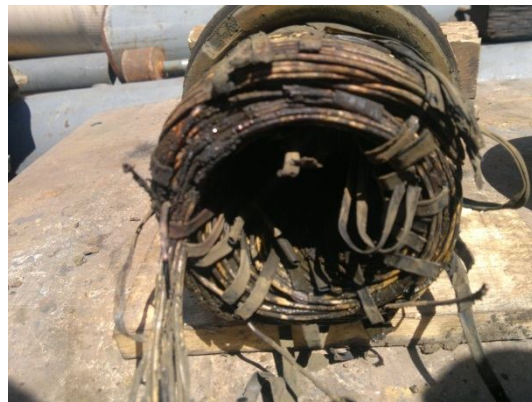
Figura No. 35 “Embobinado de motor sumergible dañado por sobrecarga”
