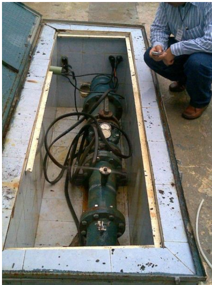
Figura No. 38 “Tren de Descarga fuera de norma”
