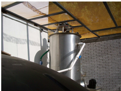
Vista parcial del reactor anaerobio R-I
