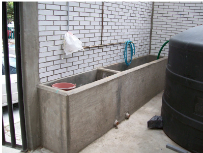
Estanques de sedimentación y reactor R-II
