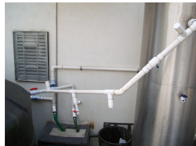
Línea de conducción entre ambos reactores
