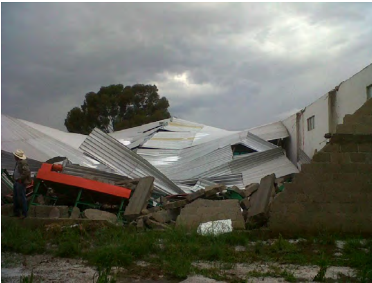
Imagen 6.4. Daños a la bodega. Nazateth, Atltzayanca, Tlaxcala.
