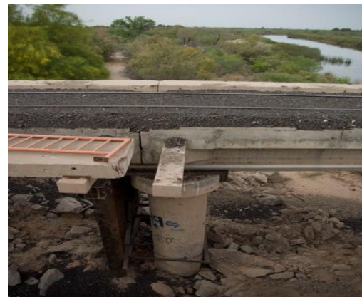
Figura 2.12. Puente del ferrocarril casi colapsado debido al desplazamiento horizontal. Foto por Scott Brandenburg, 17 de abril de 2010 (GEER, 2010)
