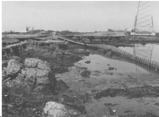
Figura 2.2. Las vías del tren cerca de Paso de Burras en Lázaro Cárdenas, sufrieron deformaciones como resultado del Tsunami del 19 de septiembre de 1985 (Lomnitz y Castaños, 1985)
