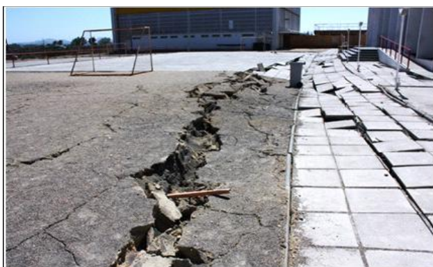
Figura 1.38. Grietas causadas por el fenómeno de licuación en el patio de la escuela en San Pedro de La Paz. (Mendoza et al. , 2011) 67
