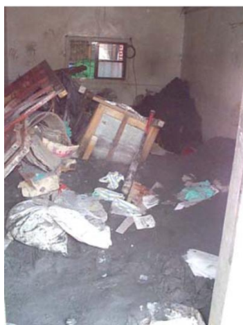
Figura 1.19. Vista interior de la vivienda mostrada en la Fig 1.18, se aprecia el suelo licuado y daño a los muebles. (EEFIT, 2007)
