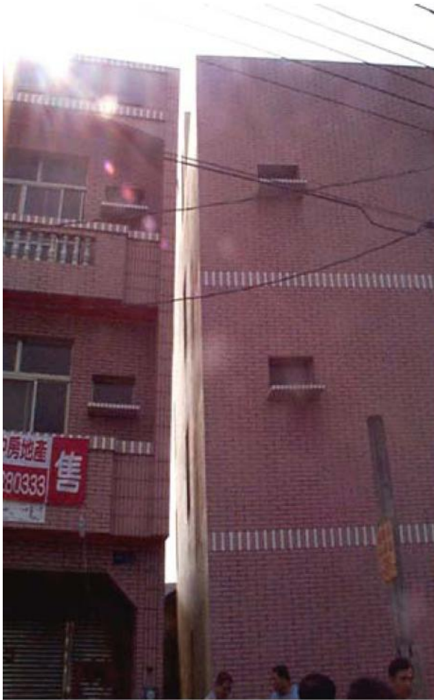
Figura 1.20a. Inclinación de un edificio causado por el desplazamiento diferencial vertical en la cimentación (EEFIT, 2007) 50
