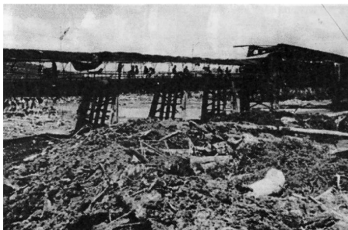
Figura 1.12. Puente Atalanta, sufrió desplazamiento horizontal de aproximadamente 2 m, el tramo final colapso (Sauter, 1994)
