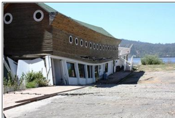
Figura 1.40. Restaurante dañado por grietas y un desplazamiento vertical en la orilla del río Bio Bio (Mendoza et al., 2011)
