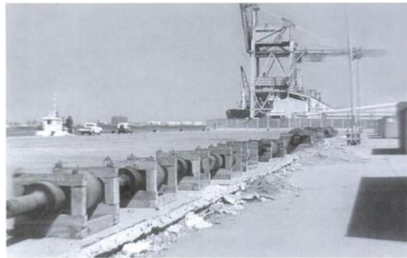
Figura 2.1. Desplazamiento vertical del piso en la terminal de usos múltiples de la planta SICARTSA, Lázaro Cárdenas, Michoacán 19 de Septiembre de 1985 (Farreras, Ortiz y Alcalá, 2003)
