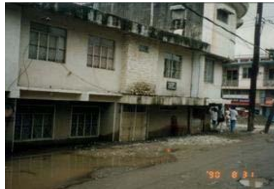
Figura 1.6. Desplazamiento vertical e inclinación de un edificio adyacente al de la figura 1.5 (Orense, 2011) 43
