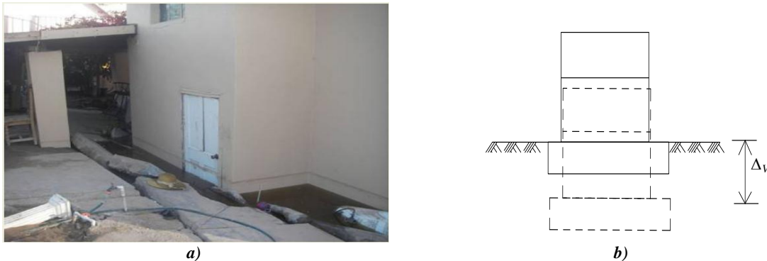
Figura 2.19. a) Estructura de dos niveles en el poblado de Oaxaca sufrió desplazamiento vertical de aproximadamente 1 m (GEER, 2010) 73 y b) Representación esquemática para una estructura de dos niveles dañada por un desplazamiento vertical debido a la pérdida de carga del suelo
