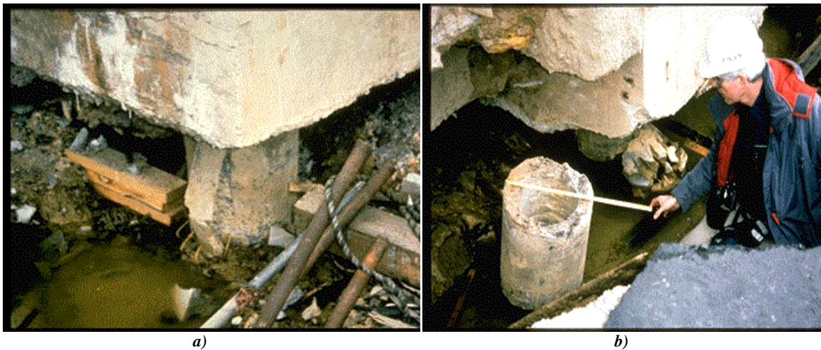
Figura 1.14. a) Pilote agrietado debido al desplazamiento horizontal de aproximadamente 20 cm, los pilotes no fueron diseñados para resistir desplazamientos laterales (Akai et al., 1995) 48 y b) El pilote fue cortado y desplazado, había sostenido una construcción que funcionaba como almacén (Akai et al., 1995)
