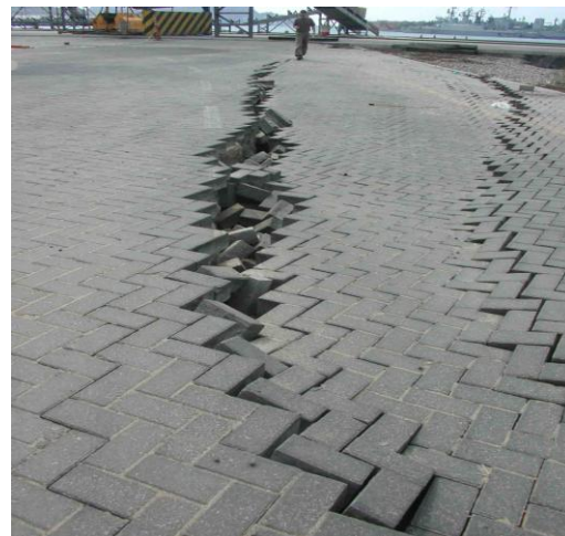
Figura 2.8. Desplazamiento horizontal en el puerto de Manzanillo, esta parte fue cerrada temporalmente al tráfico (GEER, 2003)
