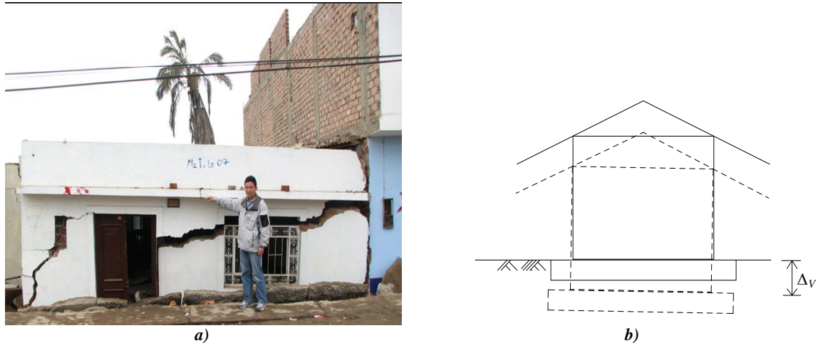
Figura 1.28. a) Residencia de un nivel sufrió un desplazamiento vertical de aproximadamente 0.7 m, y sus muros presentaron severas grietas (Elnashai et al., 2008) 58 y b) Representación esquemática del tipo de modo de falla para un edificio de un nivel con cimentación flexible que presentó desplazamiento vertical
