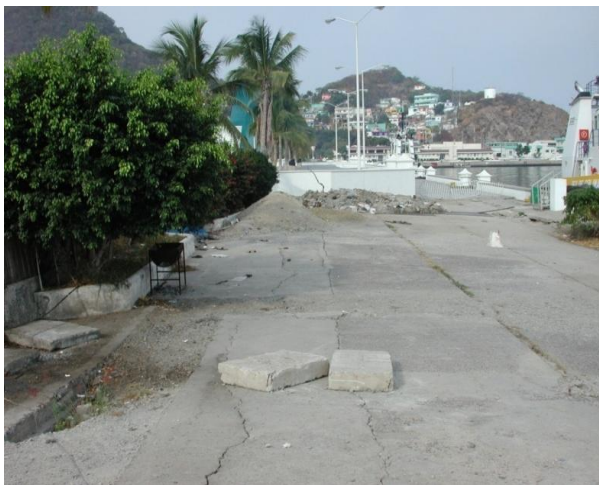
Figura 2.7. Desplazamiento vertical y horizontal del suelo debido al fenómeno de licuación de un paseo peatonal, cerca del centro de la ciudad de Manzanillo. La forma cóncava de la acera, a la derecha de la fotografía sugiere un asentamiento de la superficie del suelo (GEER, 2003)
