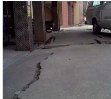
Figura 1.20b Asentamiento con respecto al nivel de calle. (EEFIT, 2007)
