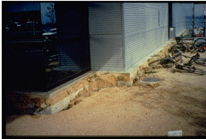
Figura 1.13. Desplazamiento vertical de aproximadamente 30 cm, alrededor del edificio de la estación terminal del tren en Port Island (Akai et al., 1995) 47
