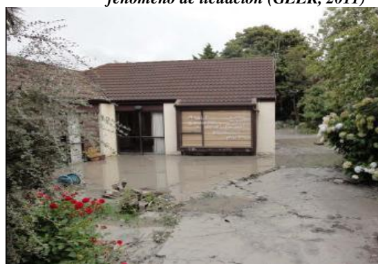
Figura 1.44. Desplazamiento diferencial vertical de aproximadamente 40 cm en una casa habitación (GEER, 2011) 75
