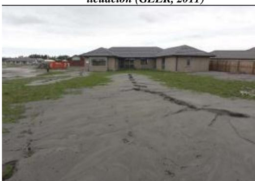
Figura 1.43. Grieta de 30 m de longitud (GEER, 2011)
