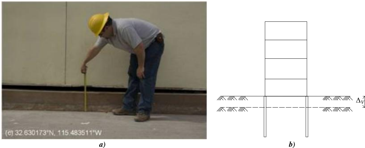
Figura 2.17. a) Medición del desplazamiento vertical diferencial entre piso de la estructura y el piso del patio. Foto de Scott J. Brandenburg, 17 de abril de 2010 (GEER, 2010) y b) Representación esquemática del desplazamiento vertical del suelo debido al fenómeno de licuación
