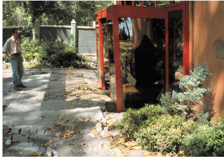
Figura 1.24. Desplazamiento vertical en la entrada al Hotel Sapanca, foto tomada por Thomas L. Holzer, (USGS, 2000) 54
