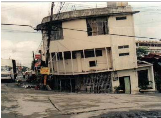
Figura 1.5. Desplazamiento vertical e inclinación de un edificio de concreto reforzado (Ishihara, Acacio y Towhata, 1993) 42
