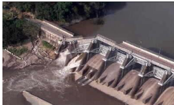
Figura 1.16. Presa Shikung después del sismo de Chi-Chi (Moh et al., 2001)
