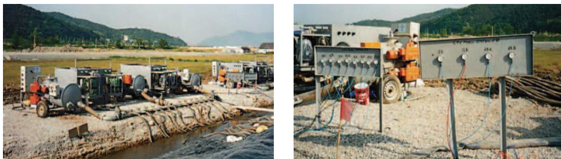
Figura 6.10.- Sistema de bombeo de vacío (Geopac, 2010)
