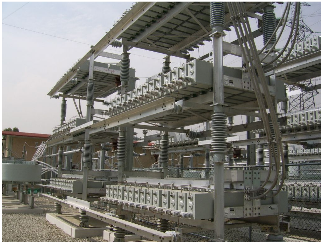
Figura 3.27.: Bancos de capacitores del TSC
