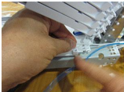
Figura 3.44. Dirección del tubo holgado a la entrada de la charola.
