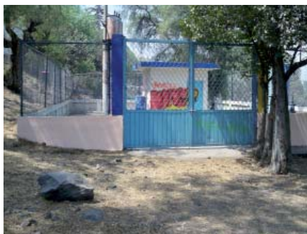
La fotografía muestra la bomba de agua que se encuentra en el Relingo.
