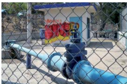
Instalaciones de bomba de agua.
