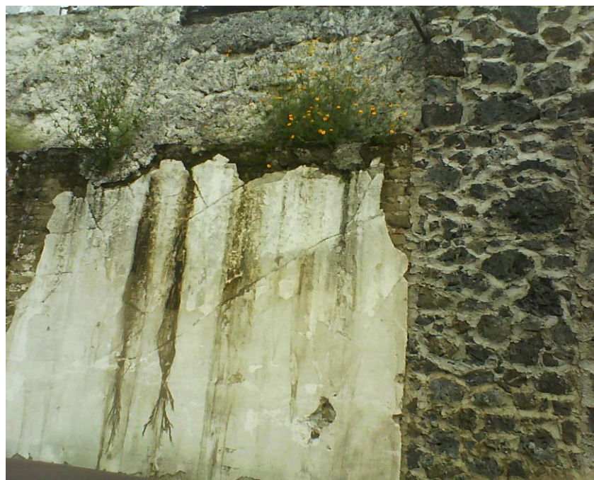
Fig. 36 Deterioro de materiales por el paso del tiempo.
