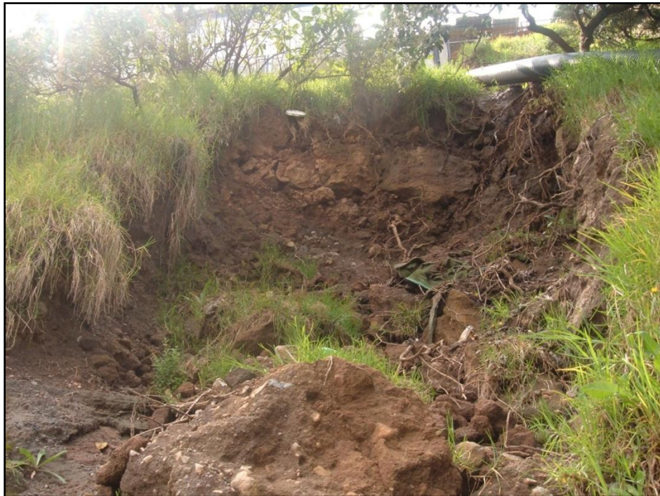
Deslizamiento rotacional, este material se desplazó sobre una superficie cóncava. Las características físicas como las intensas lluvias y las antrópicas son los principales agentes desencadenantes de estos procesos.
