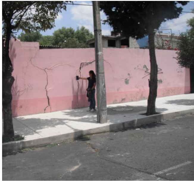
Figura 3.64 Barda de una vivienda fracturada en la calle Poniente 37, al SW del Peñón de los Baños.
