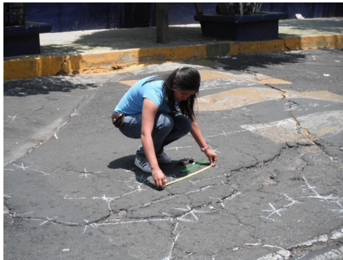
Figura 3.60 Pavimento fracturado en la calle Matamoros.
