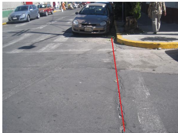
Figura 3.18 Fotografía donde se muestra el pavimento fracturado en la calle 5 de febrero, en las inmediaciones de la Basílica de Guadalupe
