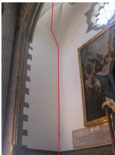
Figura 4.4 Fotografía de las fracturas que se encuentran al interior del templo “El Pocito”.
