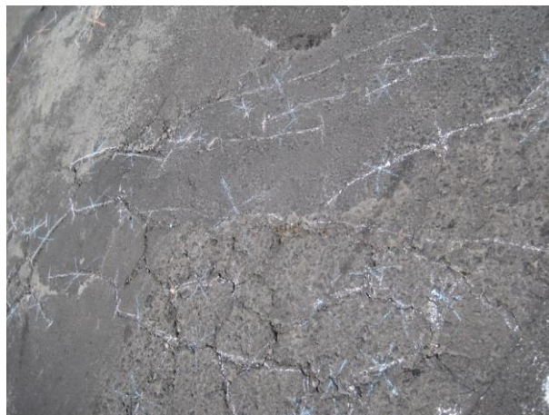
Figura 3.68 Fracturas en el pavimento de la calle Norte 194.
