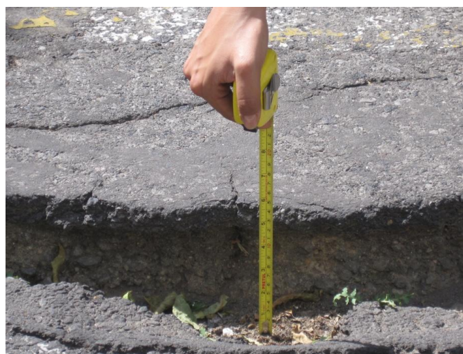
Figura 1.9 Medición del desplazamiento vertical.
