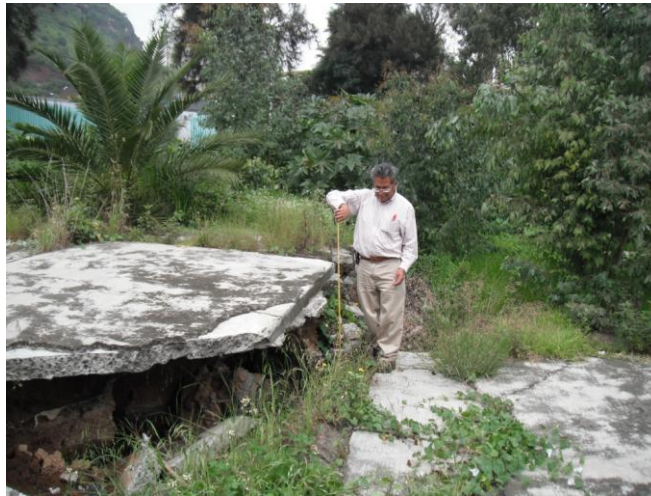
Figura 3.43 Fotografía de la falla que cruza en el estacionamiento de la escuela ubicada al NE del Peñón del Marqués.
