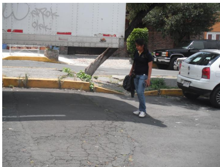
Figura 3.63 Pavimento fracturado en la calle Poniente 37, al SW del Peñón de los Baños.
