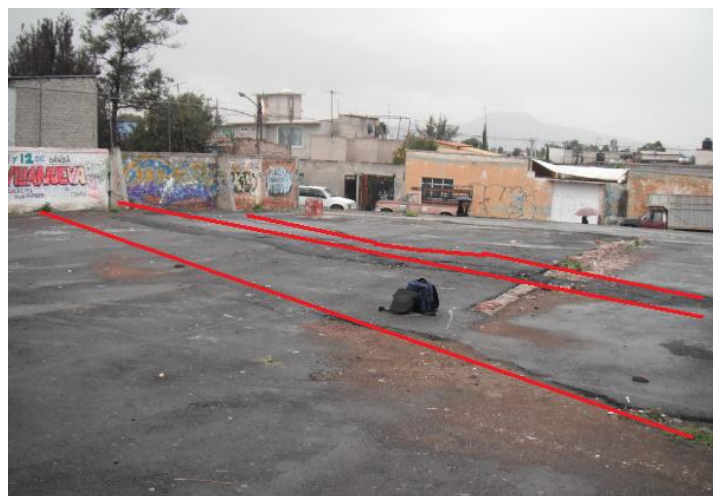
Figura 3.47 Fotografía de fracturas en una explanada en el pueblo San Juan Ixtayopan.
