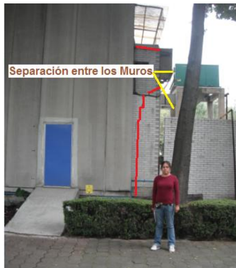
Figura 4.14 Fotografía de las aulas más afectadas por fracturas en la FES Zaragoza.
