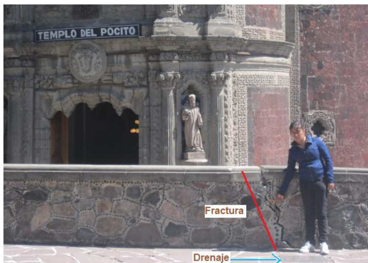
Figura 4.8 Ejemplo del fracturamiento del drenaje
