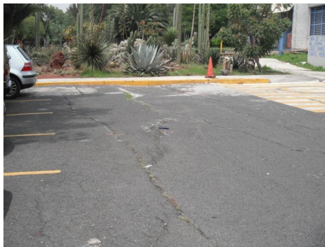
Figura 3.37 Fotografía que muestra el lugar donde fue demolida una construcción con daños irreparables causados por fracturas. En la actualidad es un jardín de cactáceas.
