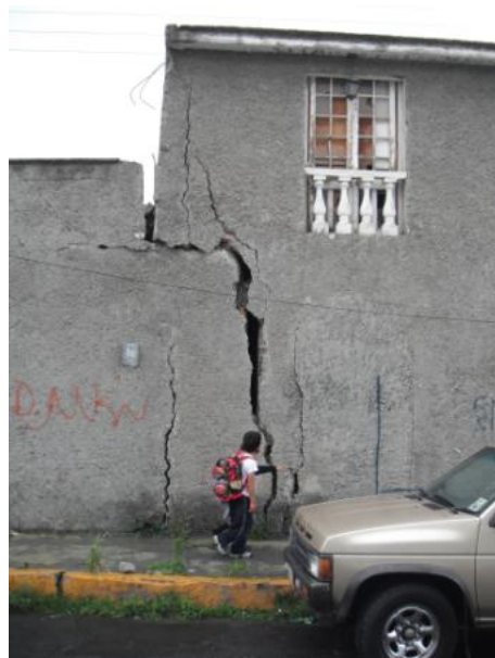
4.21 Fotografía de una construcción severamente afectada
