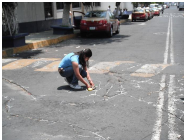
Figura 1.3 Área fracturada delimitada
