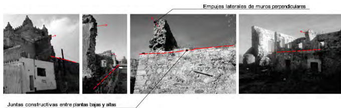
Volteo de muros en plantas altas en Tepeaca, Tecali y Totimehuacan.
