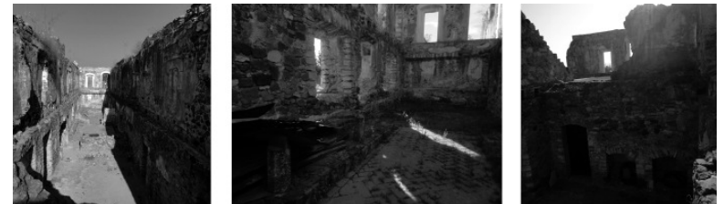
Vistas del Refectorio, ante la carencia de entrepisos, de los soportes de cantera para las mesas de madera y nichos para hornos en cocina.
