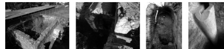
Sistema de captación, extracción y almacenaje de agua.
