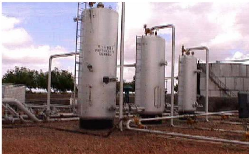
Figura 3-12 Tren de separación (separadores de alta presión, baja y de prueba)
