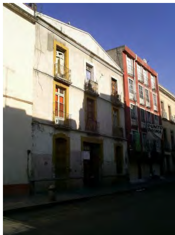
Figura 52: Vecindad muy deteriorada en la calle Academia
