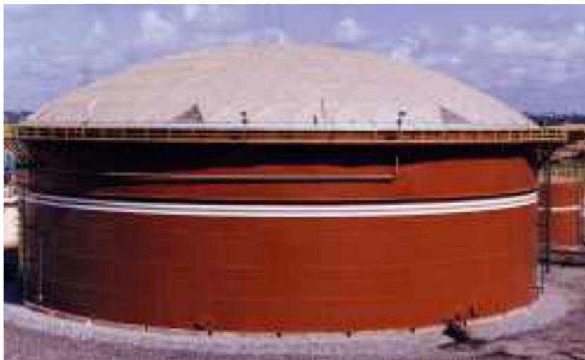
Figura 3.7 Tanque de Almacenamiento de techo fijo tipo domo.
