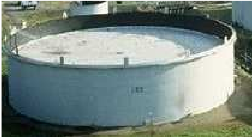
Figura 3.6 Tanque de Almacenamiento de techo flotante.
