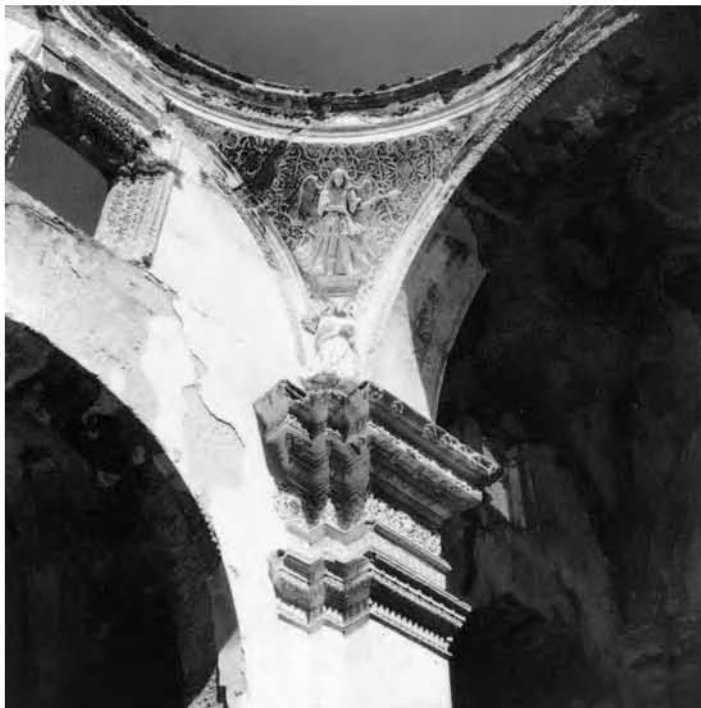
👁 Bóveda en ruinas.
