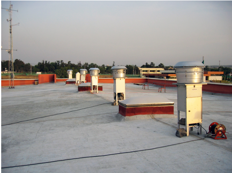
Equipos de muestreo de PM colocados en la azotea de la UTTEC (T 1 )
