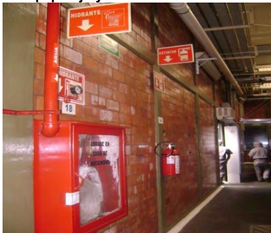
Equipo fijo y móvil contra incendio.
