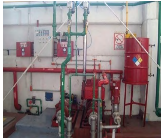
Sistema de red contra incendio.
