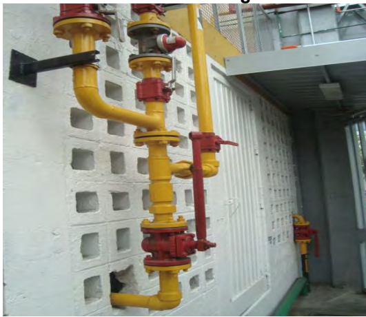
Exterior de la caseta de gas natural
