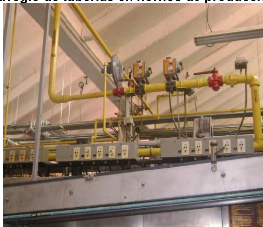
Arreglo de tuberías en hornos de producción
