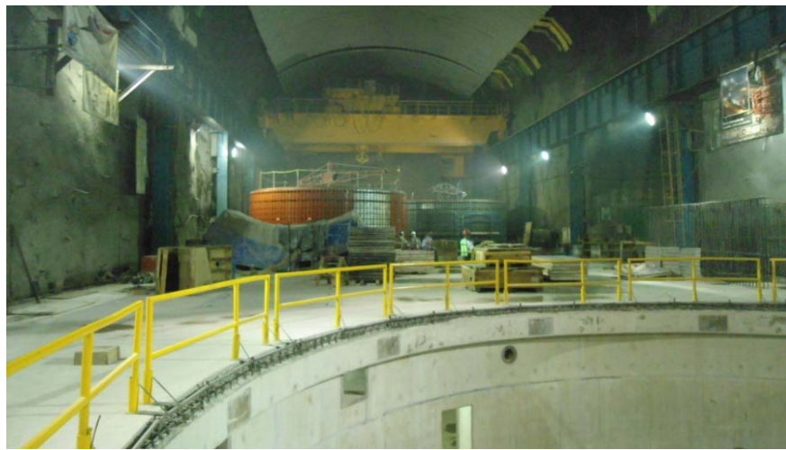
Foto 3.7 Casa de máquinas del P.H. La Yesca.
