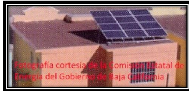
FIGURA 5.12 TECHO HORIZONTAL CON PANELES FOTOVOLTAICOS.
