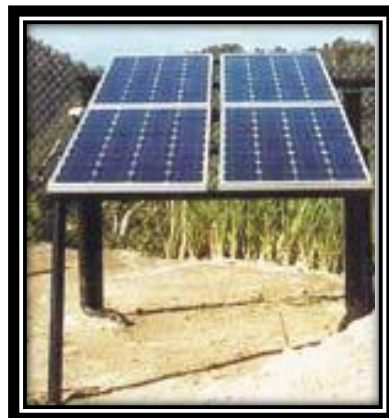
FIGURA 5.2 CONJUNTO DE PANELES FOTOVOLTAICOS TÍPICO Y SU ESTRUCTURA METÁLICA DE SOPORTE.
