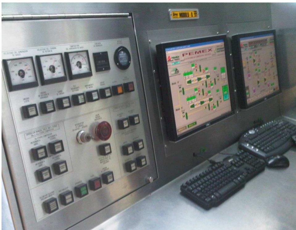
C.2. Cuarto de control.
