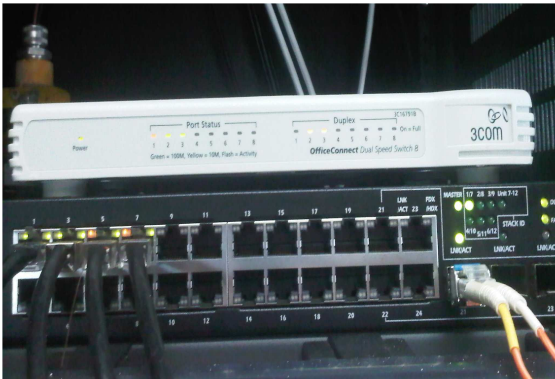
Figura 30. Switch distribuidor de las señales.
