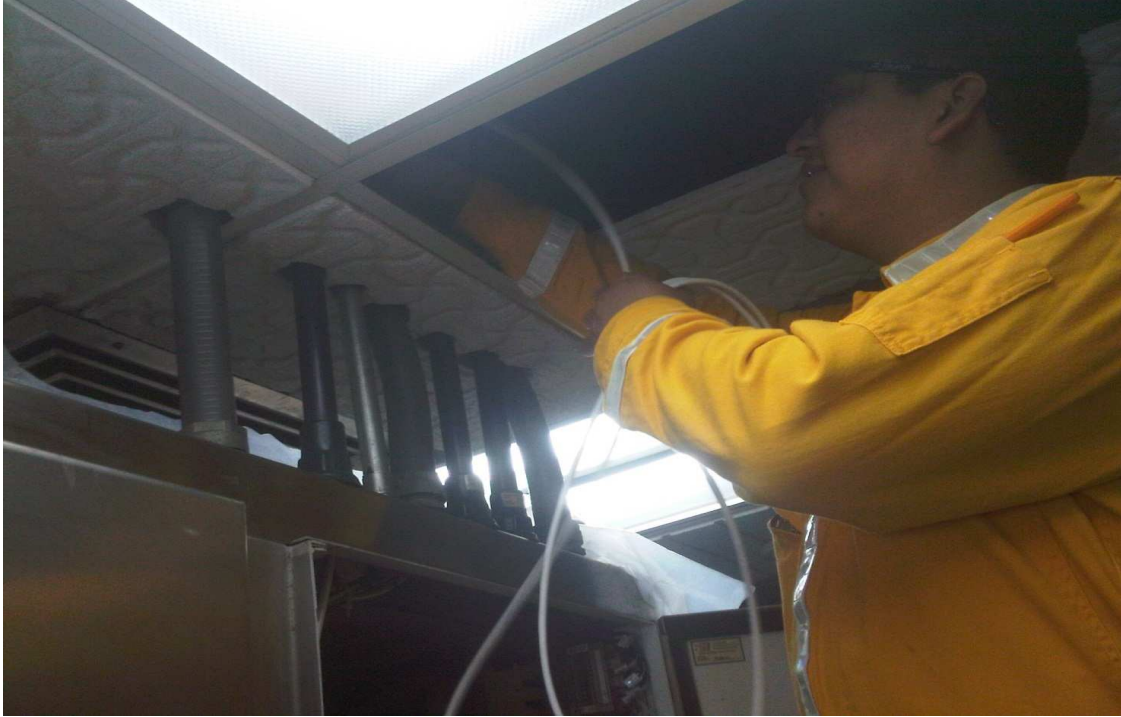
Figura 29. Cableado de la red de interconexión.
