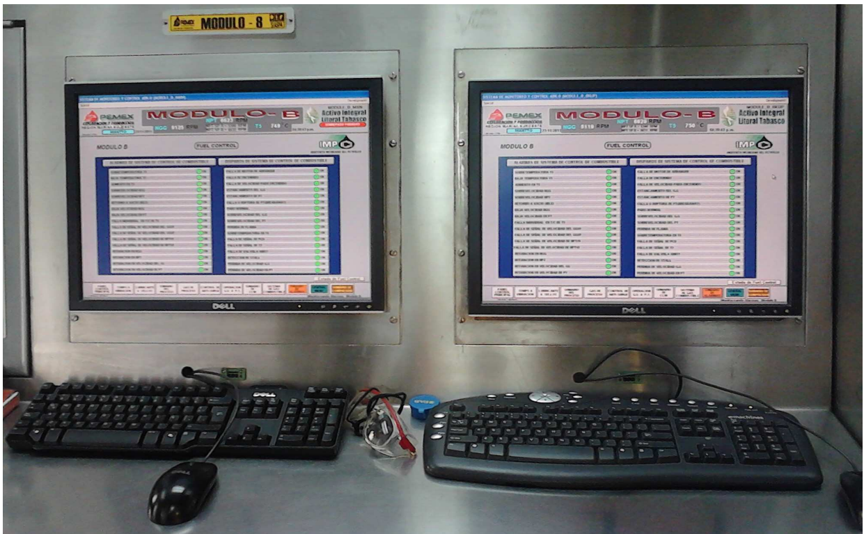
Figura 33. HMI del módulo 8: Main (izquierda) y backup (derecha).
