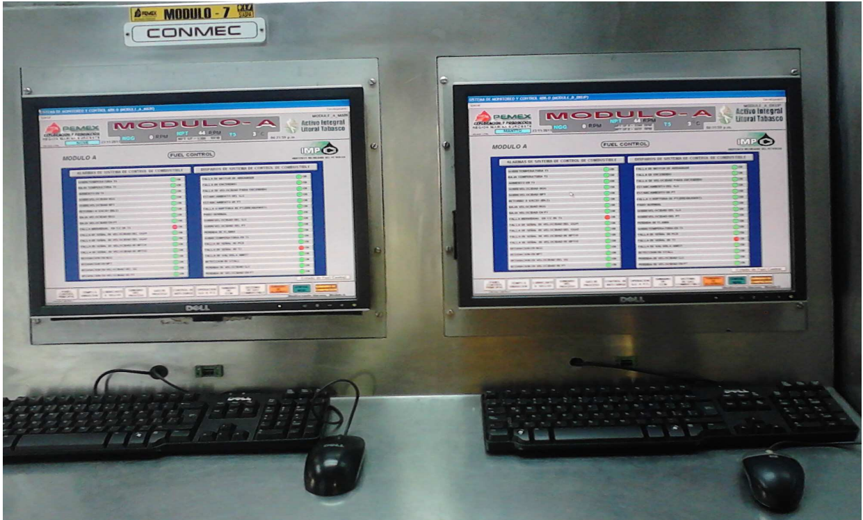
Figura 32. HMI del módulo 7: Main (izquierda) y backup (derecha).
