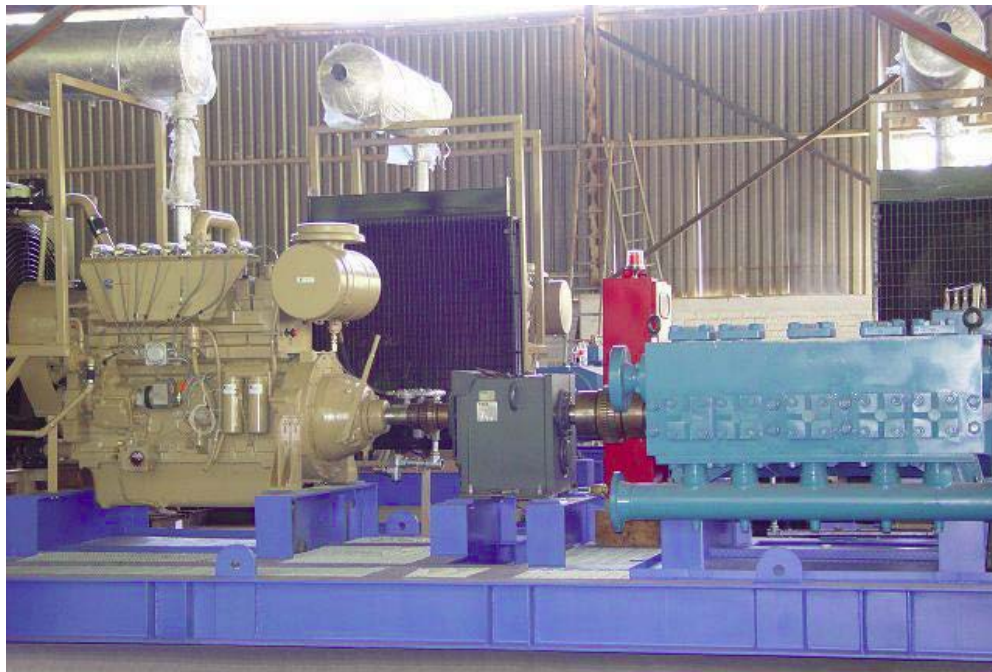
Figura.- 1.2 Foto de un equipo de bombeo similar.
