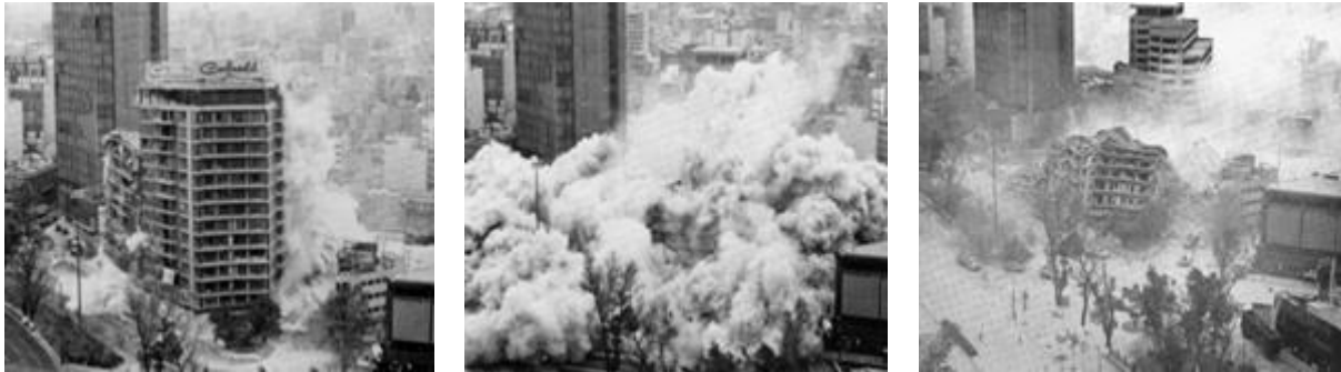
Demolición del Hotel Continental después de ser afectado por el sismo de 1985
