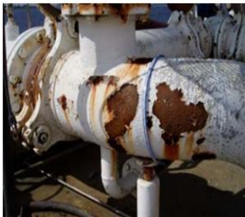
Figura 2. Corrosión en tuberías.
