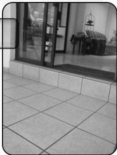
En las sala mas grande no existe rampa de discapacitados.
