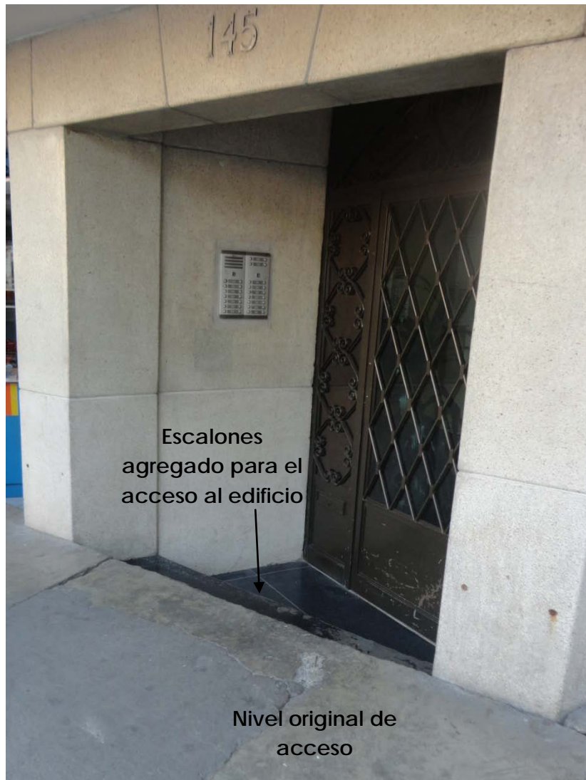
Figura 2.10 Hundimiento de la entrada del edificio sobre la calle Cumbres de Maltrata, México, D.F.
