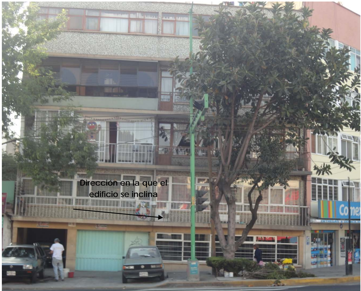
Figura 2.8 Edificio desplomado, ubicado en las calles Cumbres de Maltrata esquina eje central, México, D.F.
