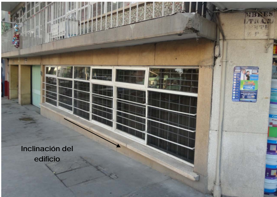
Figura 2.9 Desplomo de edificio, México, D.F.
