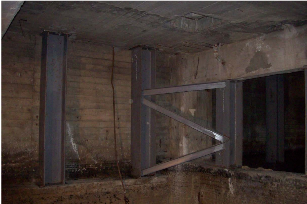
Fotografía 3. Columna apuntalada del cajón de cimentación del edificio D
