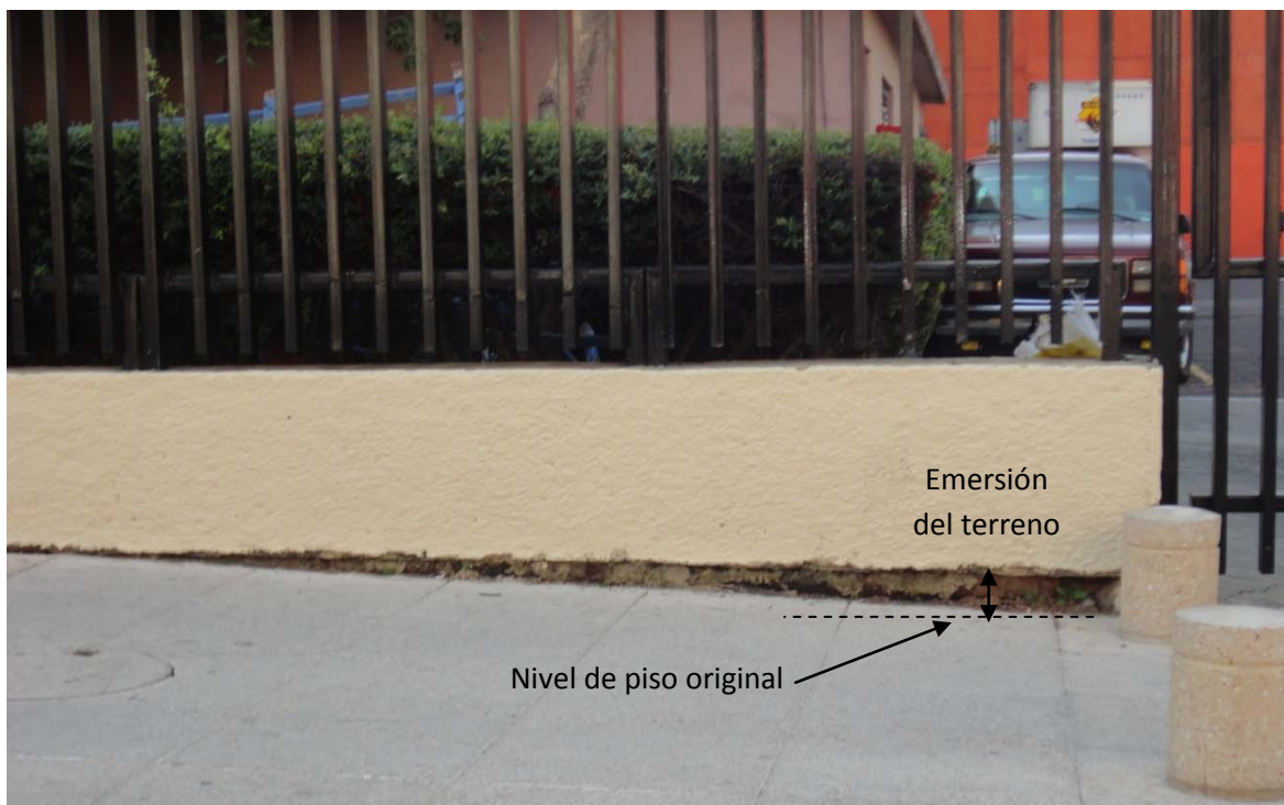
Figura 2.7 Emersión aparente del edificio de las oficinas del ISSSTE, México, D.F.
