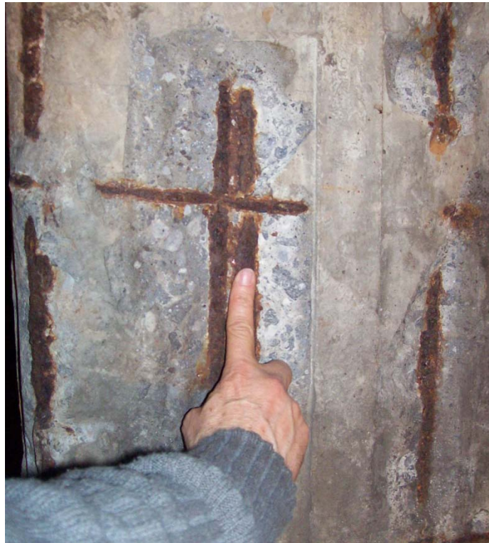
Fotografía 4. Acero de refuerzo expuesto en una columna del cajón
