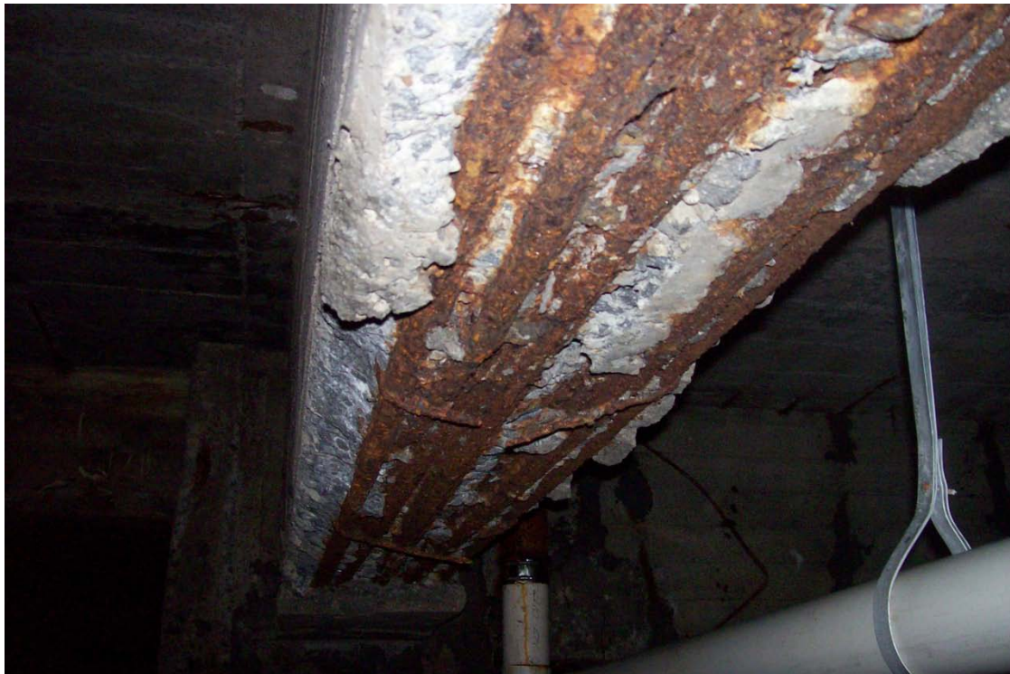
Fotografía 5. Acero de refuerzo expuesto en una viga del cajón
