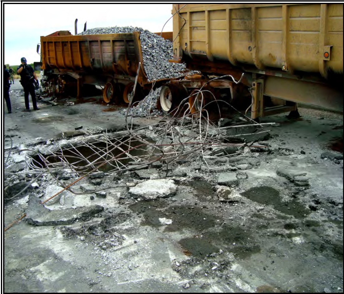
ASPECTO GENERAL DEL BOQUETE REALIZADO SOBRE EL PUENTE VEHICULAR A LA ALTURA DEL POBLADO SAN ANTONIO DE REYNA
