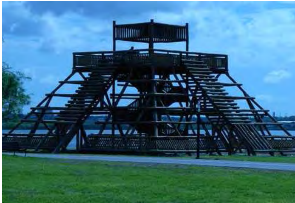
ESTRUCTURA DE MADERA DENTRO DE LA ZONA DE AFECTACION, UTILIZADA COMO JUEGO INFANTIL
