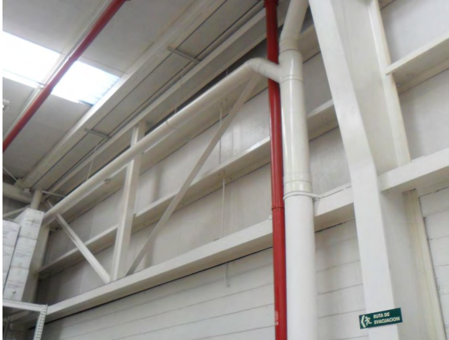
Figura 4-6. Imagen del arreglo que hay en paneles y montenes
