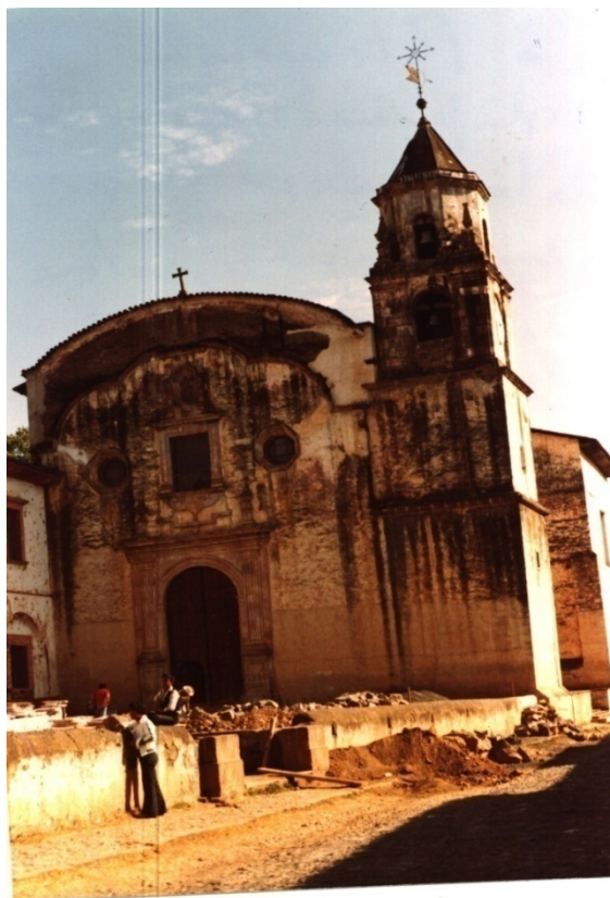
Imagen 23. Templo de San Ignacio de Loyola durante su restauración. Se distingue la diferencia de estructuras original y la bóveda de madera sobre puesta y el deterioro del edificio. Fotografía. Archivo de la Arq. Gloria Álvarez 1990 – 1992.
