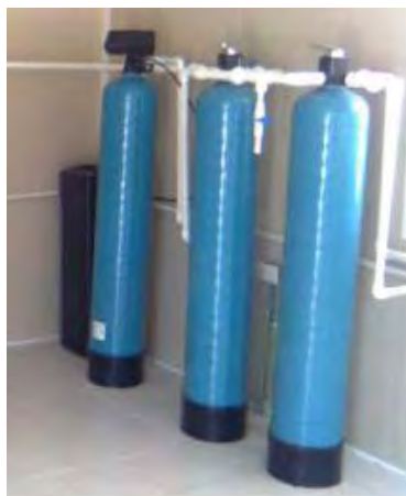
Figura 37. Filtros empacados. Fuente: CIDECALLI – CP
