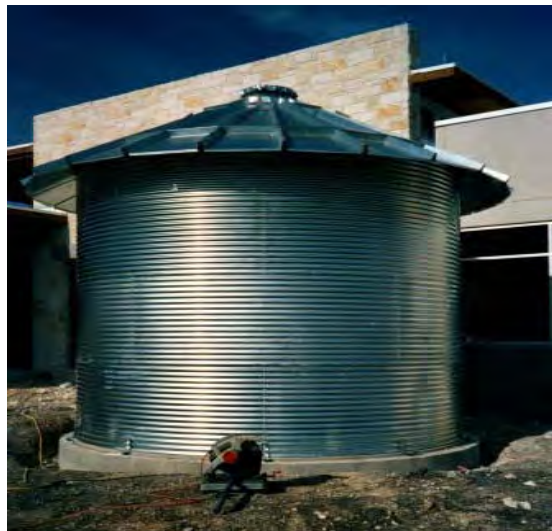
Figura 27. Tanque de acero galvanizado con revestimiento plástico de grado alimenticio. Fuente: The Texas Manual on Rainwater Harvesting.
