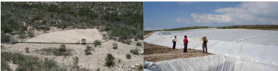
Figura 21. Ladera cubierta de concreto y ladera recubierta con geomembrana de PVC, para captación de agua de lluvia. Fuente: CIDECALLI – CP
