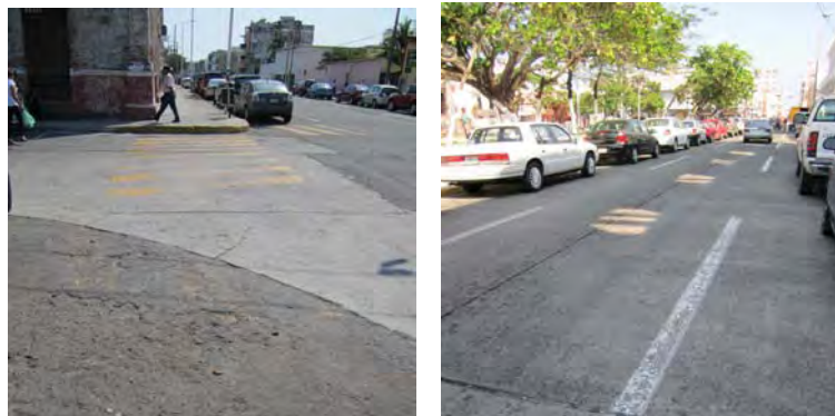
FIGURA 61 Y FIGURA 62. Estado actual de vialidades.
