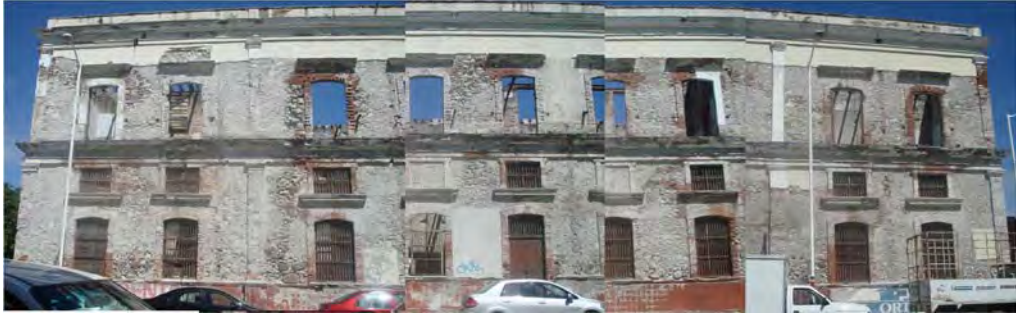
FIGURA 72. Deterioro de "La Prueba" en fachada de Hidalgo.
