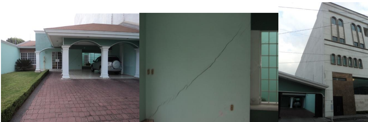
Figura 5.11 Vivienda afectada por estructura colindante (fuente: propia).
