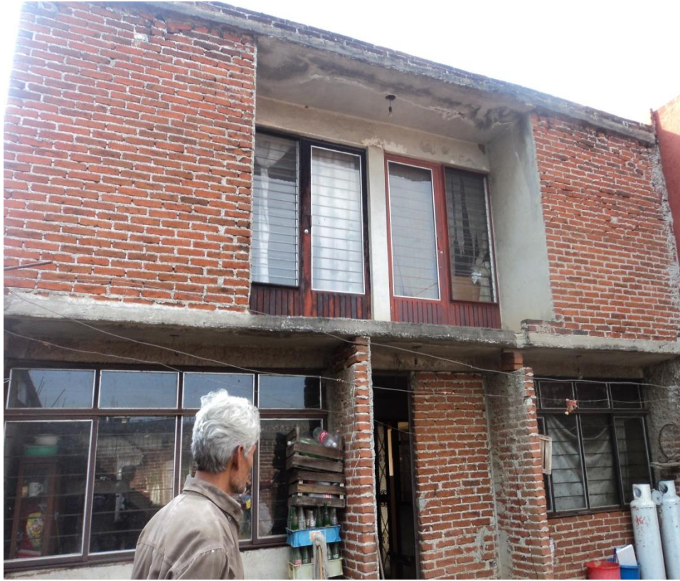
Falta de confinamiento en muros.
