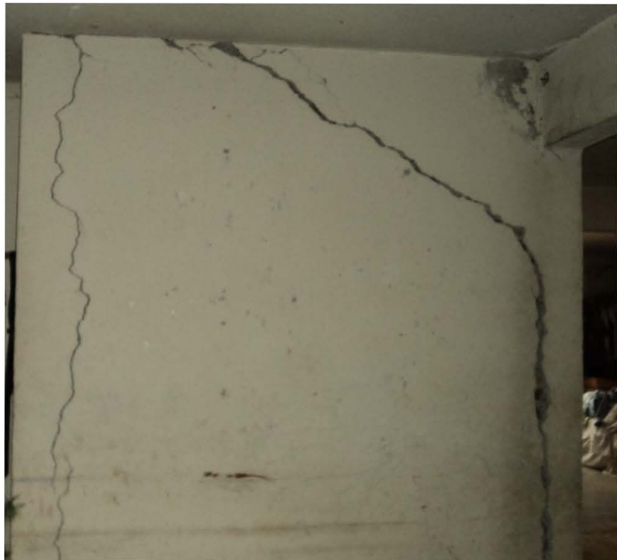
Agrietamiento en dalas y muros.
