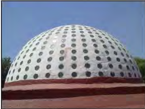
IMAGEN 2.2 CÚPULA CON INCRUSTACIONES TIPO VITROBLOCK PARA FUNCIÓN DE TRAGALUZ
