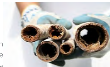
Daño en tubería de cobre por contacto con agua dura
