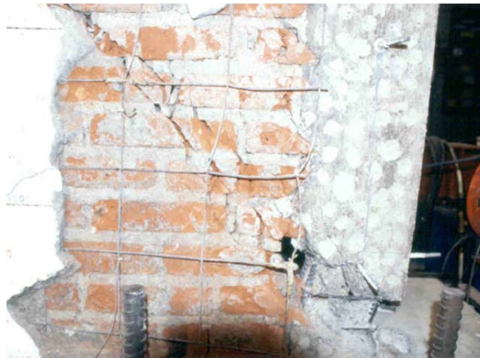
Figura 2.6. Falla de castillo por tensión diagonal (CENAPRED, 2009)
