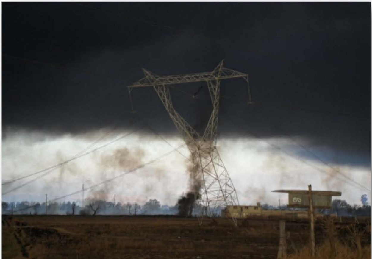
Figura 124. Vista de la T-63, en la cual se observa ladeada por los esfuerzos del colapso de la estructura adyacente.
