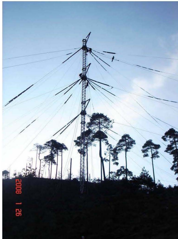
Figura 81. Vista final de la T-50, donde se observa el aislamiento sintético de las retenidas.
