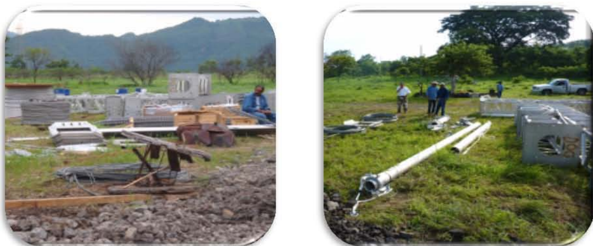
Figura 119. Habilitación del Centro de Acopio "El Caballito" ubicado a 4 km de la torre colapsada
