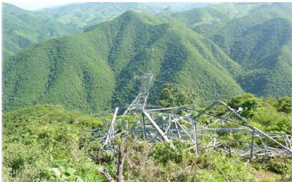
Figura 88. Vista de la T-495 colapsada
