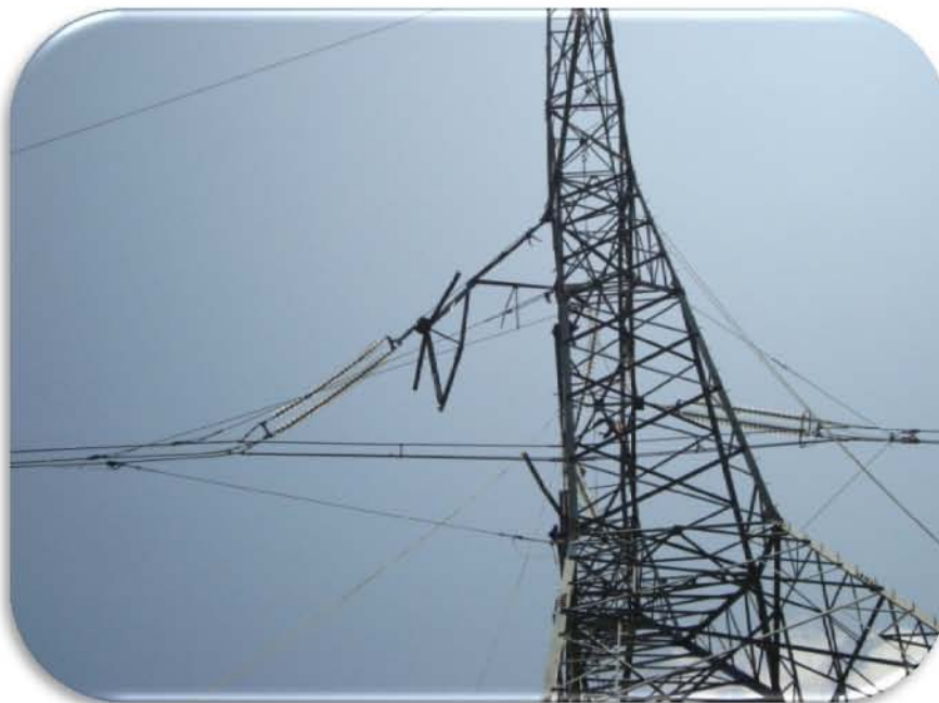
Figura 92. Vista de la T-494, en la cual se observa la trabe dañada, condiciones similares a la T-494
