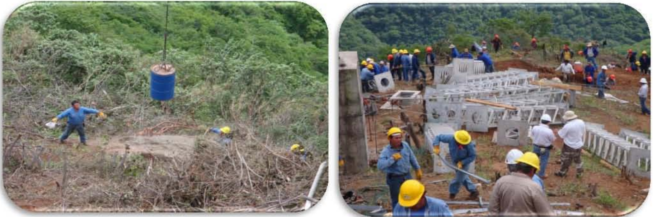
Figura 109. Con apoyo del helicóptero se realizó el traslado de estructura y colocación de muertos
