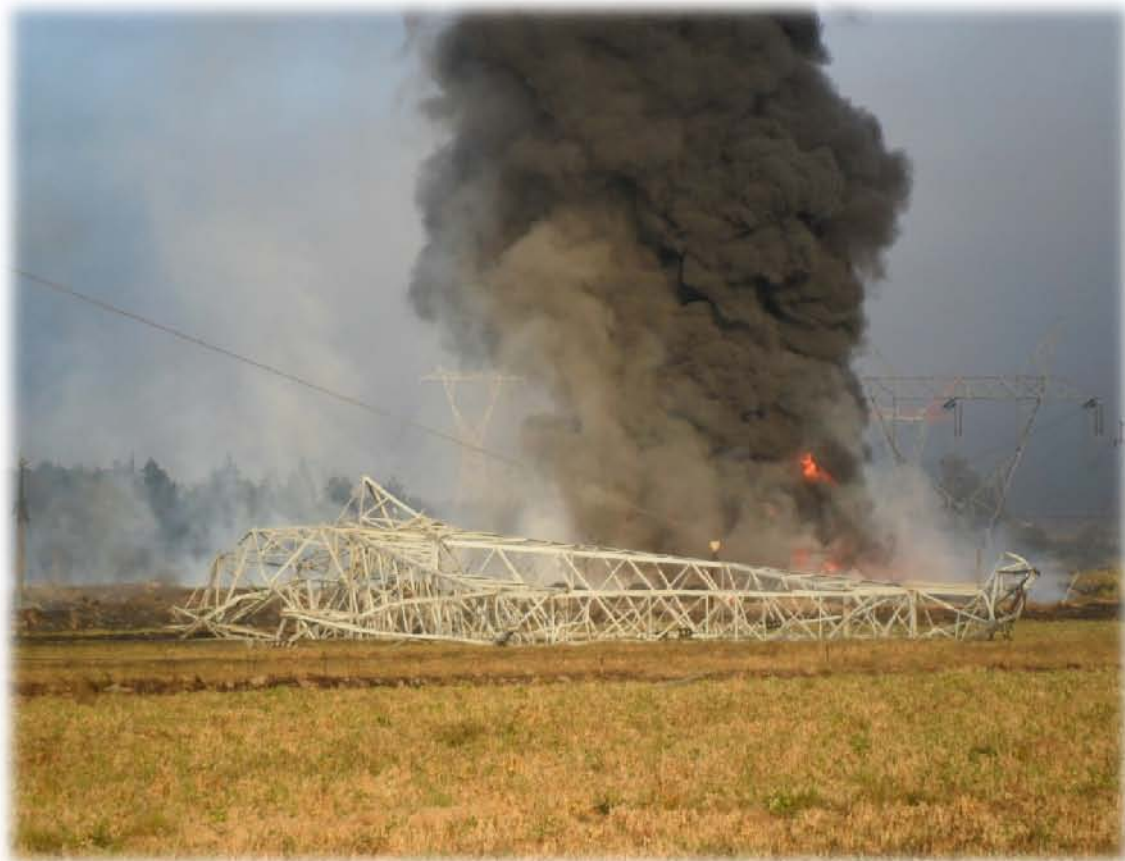
Figura 122. Vista de la T-64 colapsada
