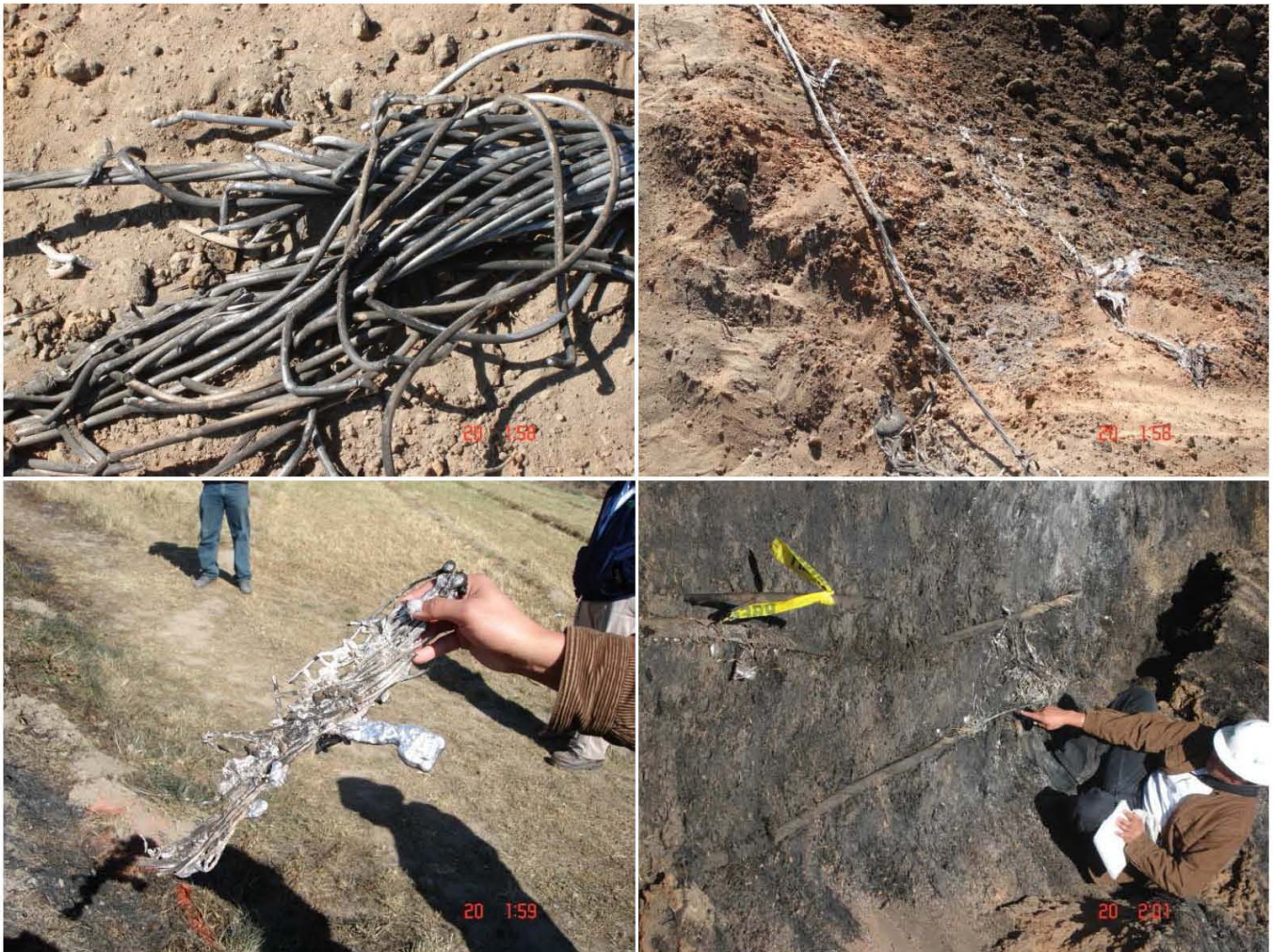
Figura 125. Daños en los conductores de la línea, los cuales se fundieron por el calor del incendio
