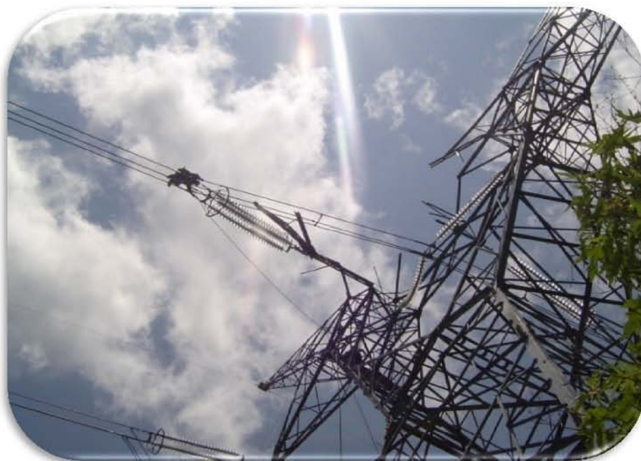
Figura 90. Vista de la T-494, en la cual se observa la trabe dañada.
