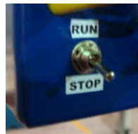
Fig. 5.3. Interruptor (run – stop) del variador de frecuencia
