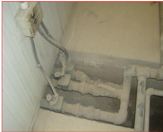
Cámara de curado y válvulas de control del vapor
