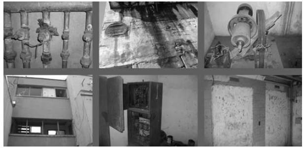
Instalaciones en deterioro por la falta de mantenimiento.
