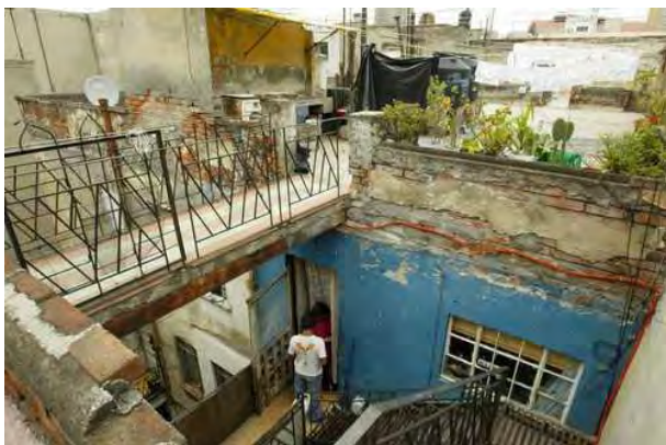
Vecindad en el centro de la ciudad, muestra daños en la estructura del edificio y en las viviendas Foto: Roberto García Ortiz
