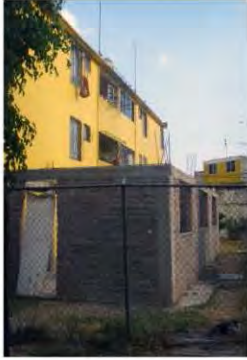
37. Ampliación sin cimentación edif. 18-D
