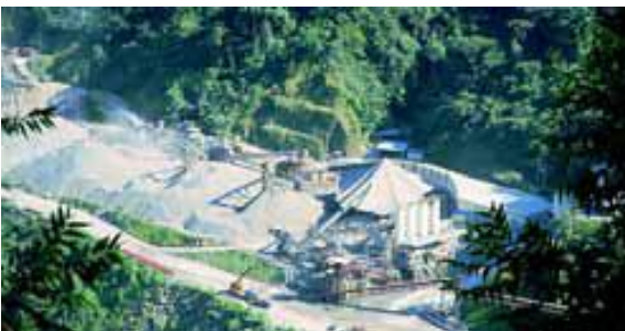
FIG. 4.11 EL DIMENSIONAMIENTO DE LA PLANTA DE PRODUCCIÓN DEL CONCRETO Y DE LAS BANDAS A UTILIZAR EN EL TRANSPORTE DEL CCR, TIENEN UNA GRAN INFLUENCIA SOBRE LA TASA DE COLOCACIÓN DEL CCR Y ESTA A SU VEZ SOBRE EL COMPORTAMIENTO TÉRMICO DE LA PRESA Y SOBRE LAS CONDICIONES DE ADHERENCIA ENTRE CAPAS HORIZONTALES.
