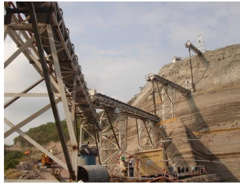
Fig. 2.22 SE CONSTRUYÓ E INSTALÓ UN SISTEMA DE BANDAS TRANSPORTADORAS QUE PERMITIERON AGILIZAR EN EL ACARREO DEL CONCRETO, (75 METROS CÚBICOS POR HORA)
