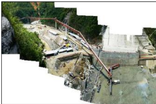
FIG. 4.22 BANDA ROTEC DE APROXIMADAMENTE 600 M DE LONGITUD, 90 CM DE ANCHO Y UNA CAPACIDAD NOMINAL DE TRANSPORTE DE 400 M 3 /HR. ESTÁ COMPUESTA POR SECTORES DE BANDA, TOLVAS, ELEMENTOS DE TRANSFERENCIA Y SOPORTES METÁLICOS SENCILLOS O TELESCÓPICOS. EN EL ÁREA DE LA PRESA SE DISPUSO DE UN DISTRIBUIDOR DE CONCRETO SOBRE ORUGAS COMPUESTO POR BANDAS TRANSPORTADORAS TELESCÓPICAS, CON ALCANCE A CASI TODA EL ÁREA DE TRABAJO Y CAPACIDAD DE HASTA 400 M 3 /HR (CRAWLER).
