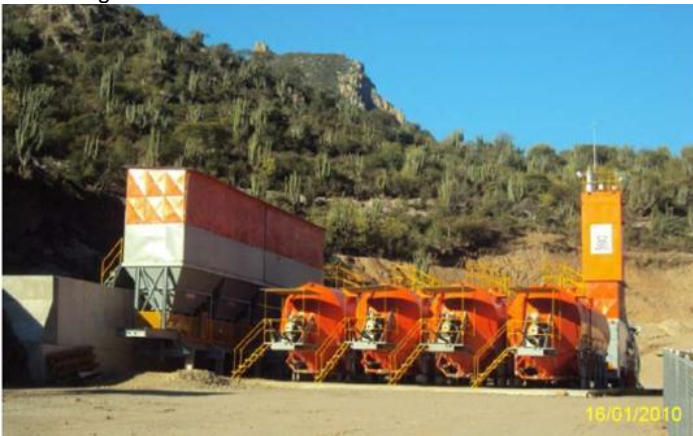
FIG. 5.21 PLANTA DE PRODUCCION DE CONCRETO
