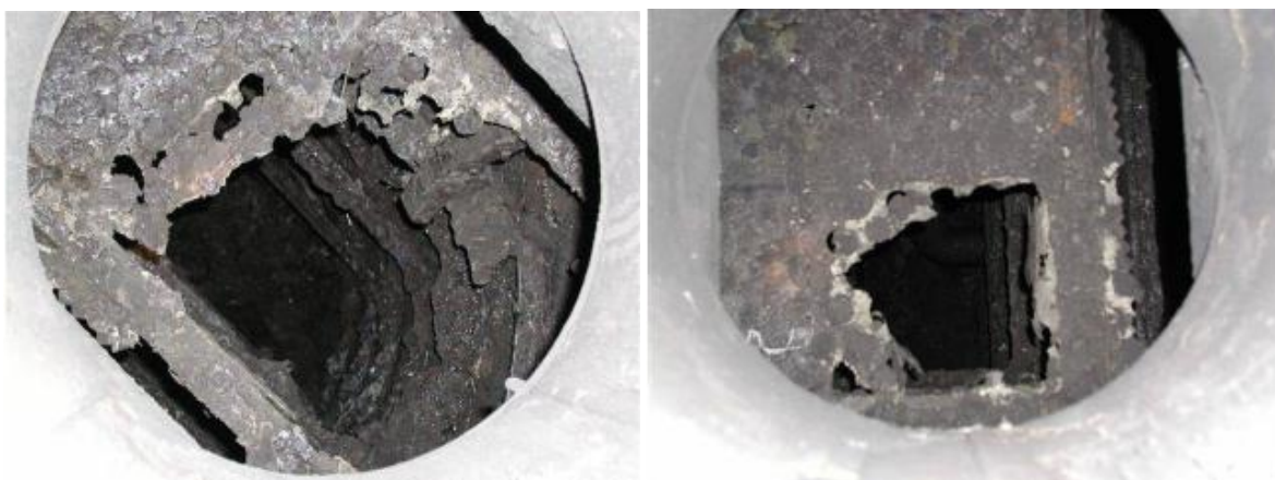
Ilustración 49: Corrosión en torres de destilación atmosférica, debido a ausencia de inhibidores de corrosión.
