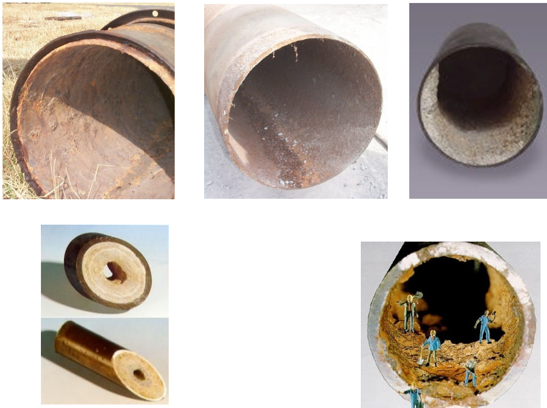
Figura 5 Incrustaciones en una tubería
