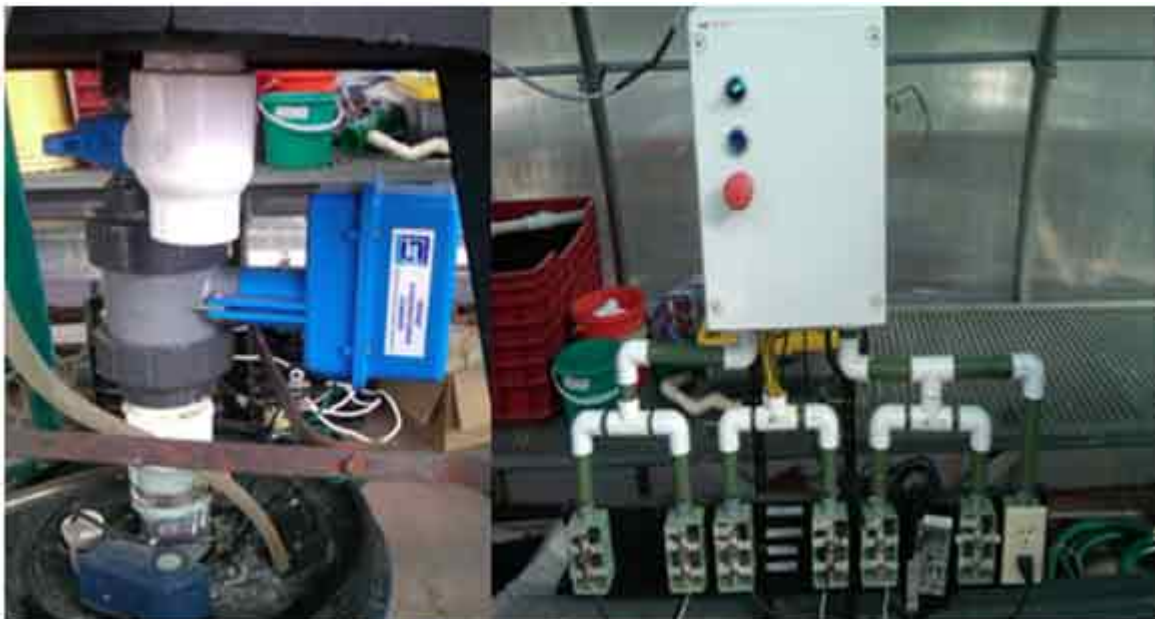
Figura 23. Electroválvula y panel de control de los SEHA
