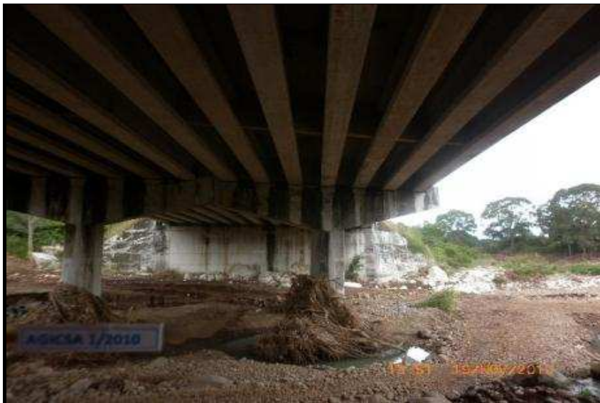
PILA No. 2, SE OBSERVA ACUMULACION DE MALEZA Y PALIZADA.
