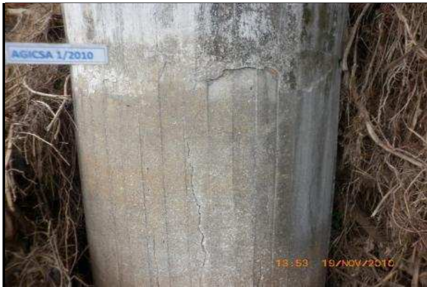
DETALLE DEL AGRIETAMIENTO QUE PRESENTA LA PILA No. 2
