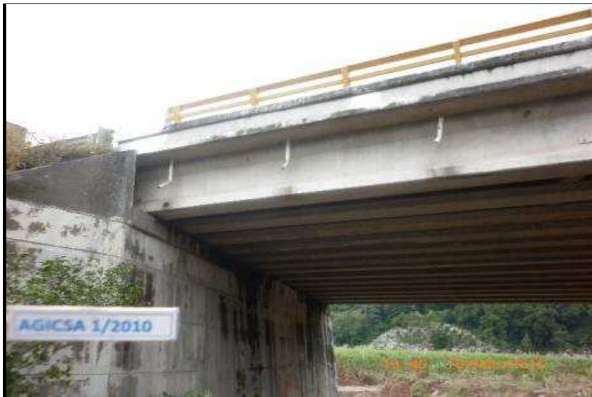
EXTENSIONES DE DRENES, EN MAL ESTADO.
