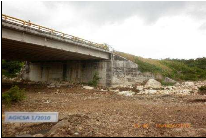
VISTA DEL ESTRIBO NO. 3, SE OBSERVAN ESCURRIMIENTOS.
