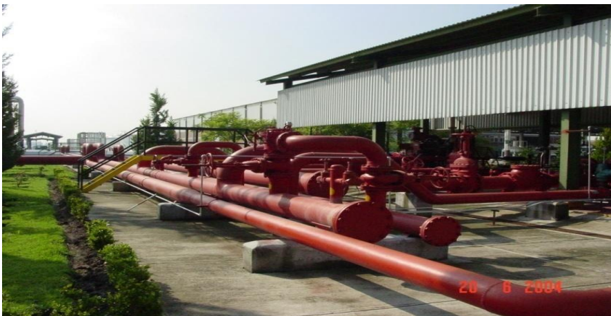
Ilustración 10. Cobertizo de bombas C.I.
