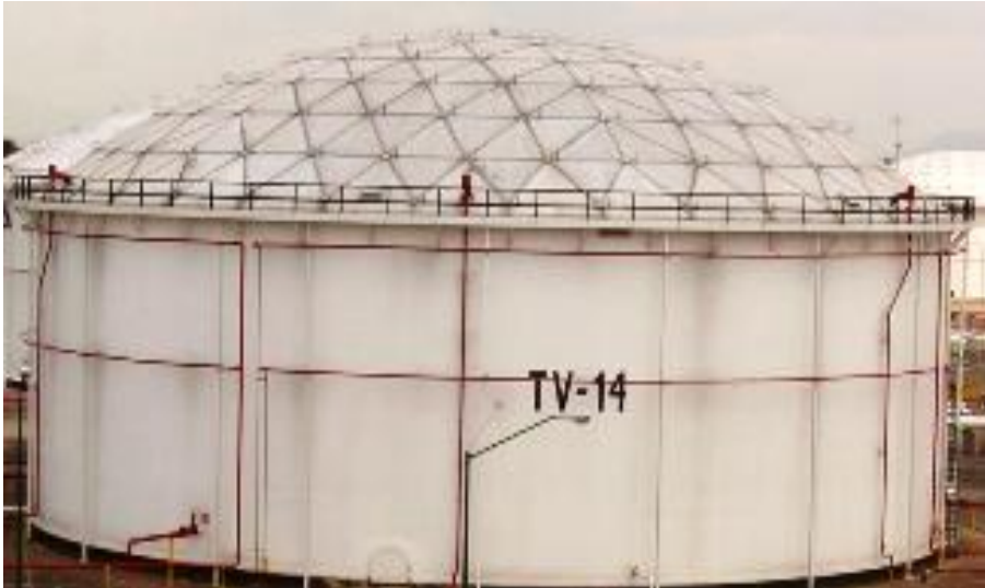
Ilustración 14. Anillos de enfriamiento y cámaras de espuma.
