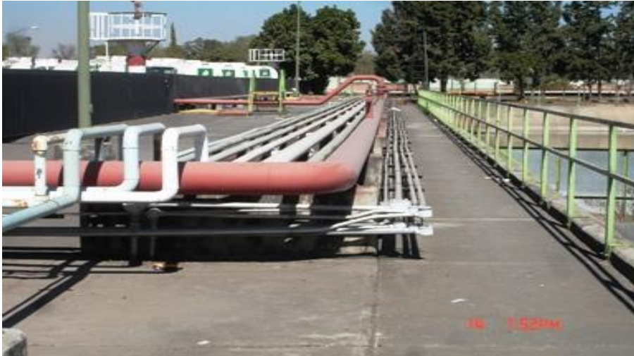
Ilustración 16. Tubería de la red de C.I. identificable por su color rojo.
