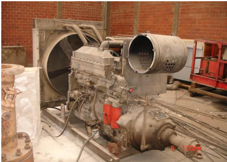
Ilustración 22. Maquina de combustión. (Cummins)
