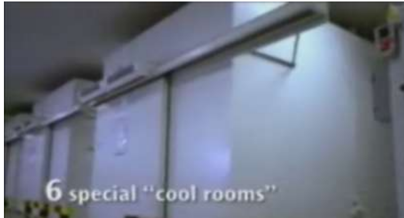
Figura 5.2.6.6 Cámaras con temperatura controlada
