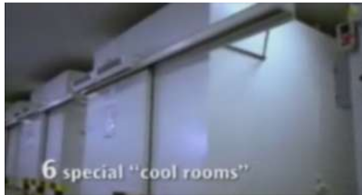
Figura 6.5.6 Cámaras con temperatura controlada
