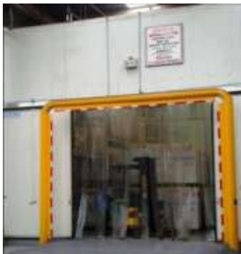
Figura 4.7 Cámaras de refrigeración y congelación AAACESA
