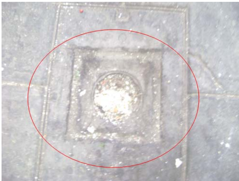
Figura 32. Registro de desagüe localizado en el local 4 en la Central de Abastos de Tultitlán
