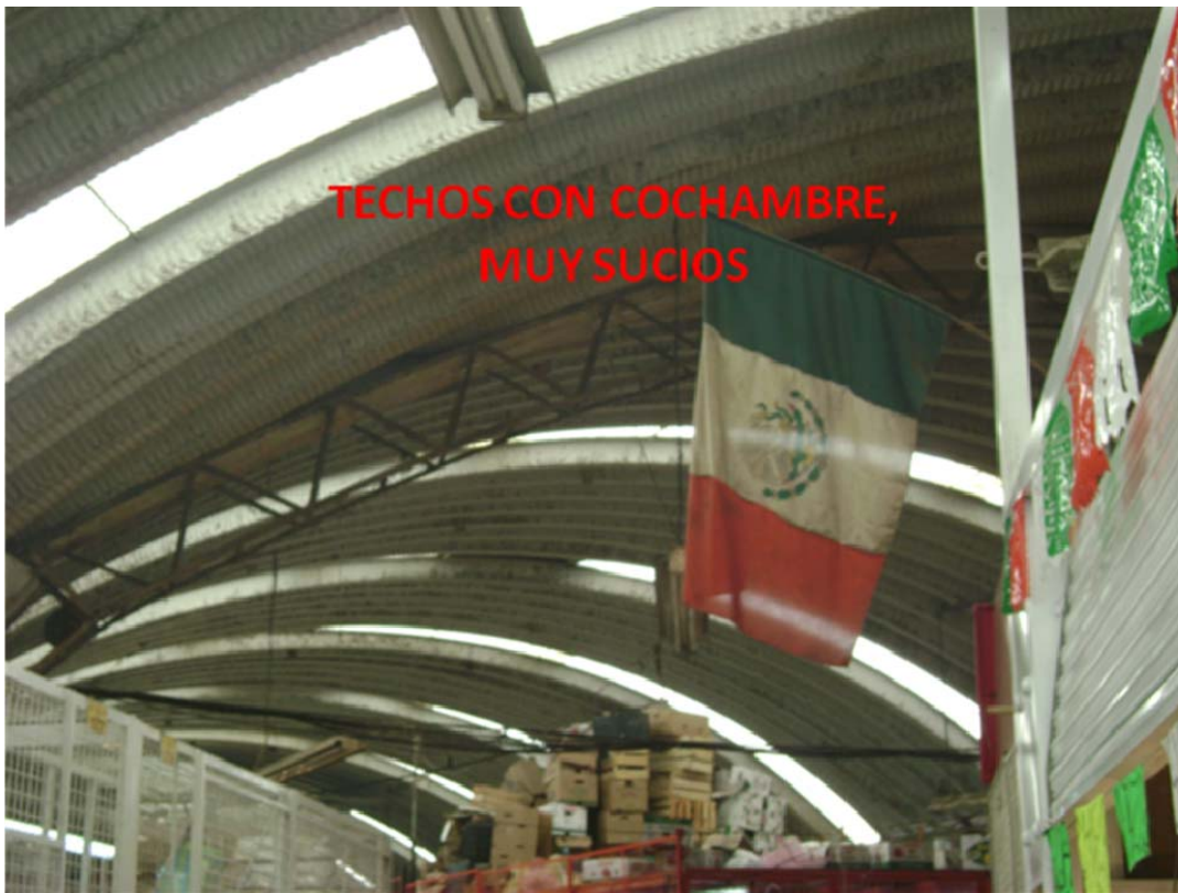
Figura 24. Techos extremadamente sucios, ubicados arriba del local muestreado
