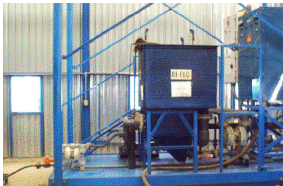
Figura 38. Planta de tratamiento de agua ECOFLOW con capacidad de 10 L/s.
